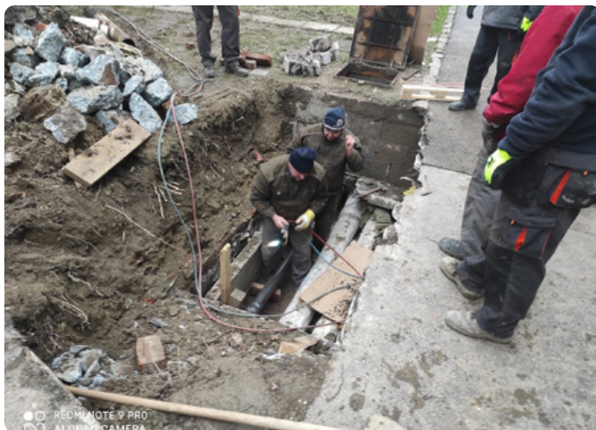
Potrubie má často problémy
