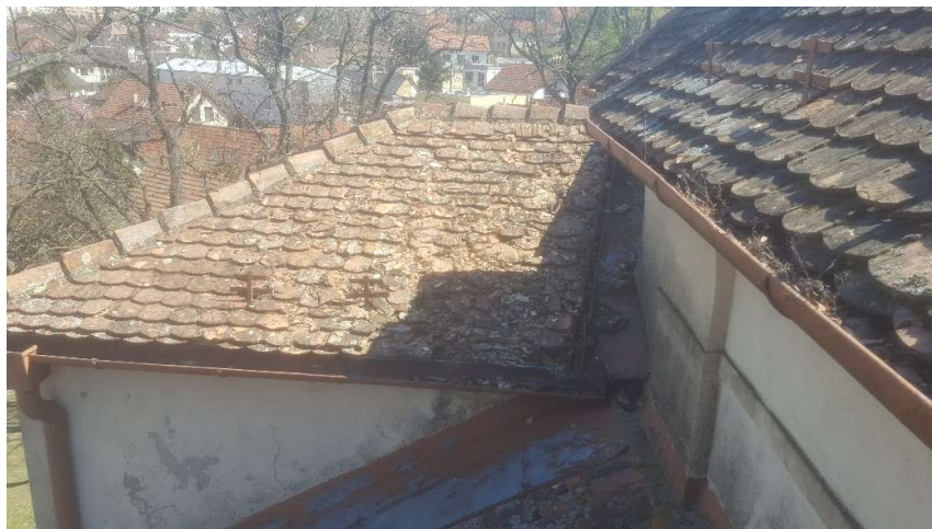
Pôvodný stav strešnej krytiny nad sakristiou pred výmenou
