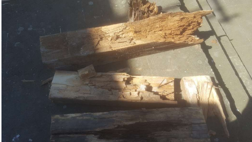
Zdegradovaná pomúrnicia na severnej časti strechy
